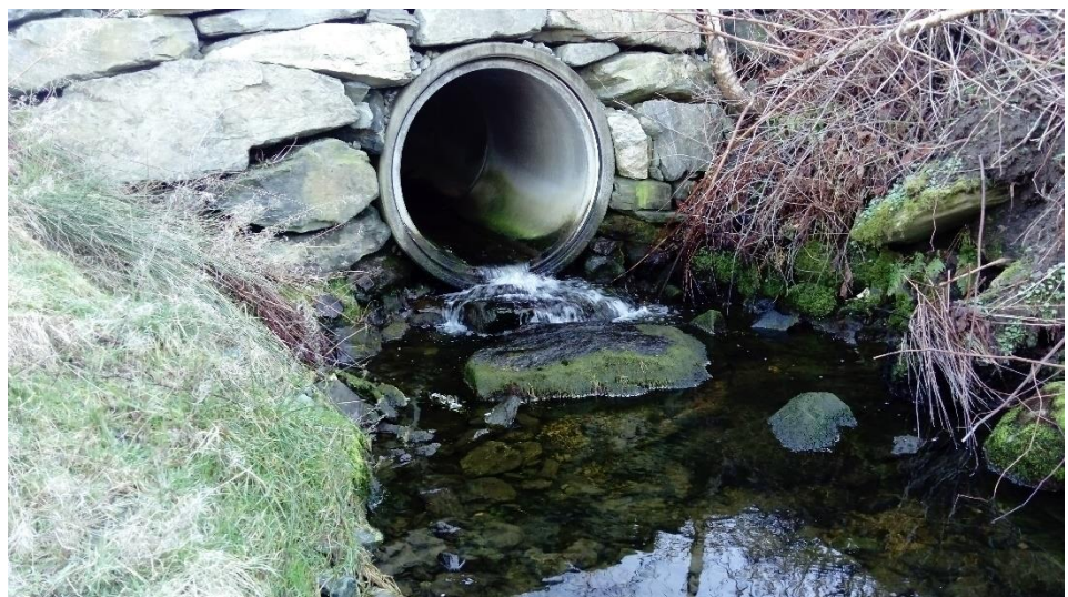
Ett av vandringshindrene som begrenser fisks vandring i Dubberselva.
