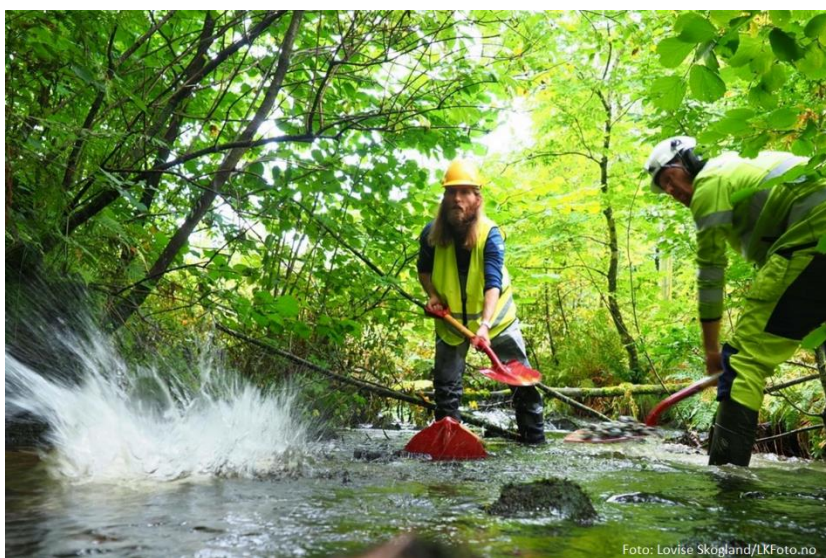
Her plasseres det ut gytegrus i Søvikbekken. Bekken var ett av fire vassdrag i Tysvær hvor det ble gjennomført tiltak.
