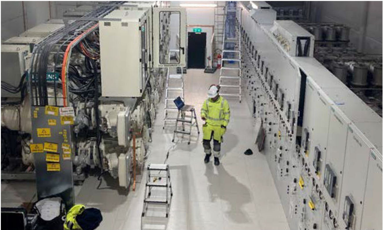
De nye høyspenningsbrytere er på plass i transformatorstasjonen på Flotmyr. Hele anlegget er kapslet og berøringsikkert.
