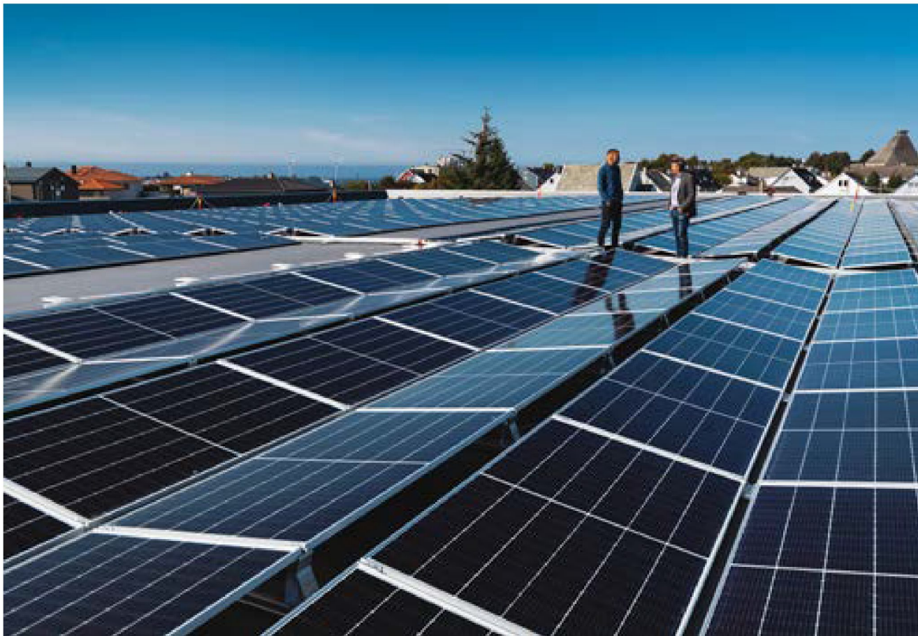
Leder for forretningsutvikling Kristian L. Gautesen og krafthandelsansvarlig Andreas Bachmann på taket av garasjelegget på Rossebø. Her har Haugaland Kraft Energi installert 938 solcellepaneler, som er en del av pilotprosjektet på Utsira. Foto: Haakon Nordvik
