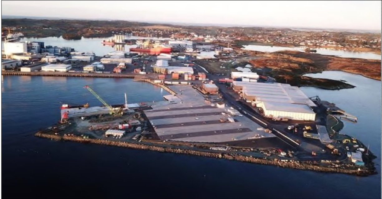
Figur 6 Bildet viser utbygging av havnearealet, så langt anleggsarbeidet var kommet i desember 2018. Kilde: Karmsund Havn IKS, 11.12.2018.
