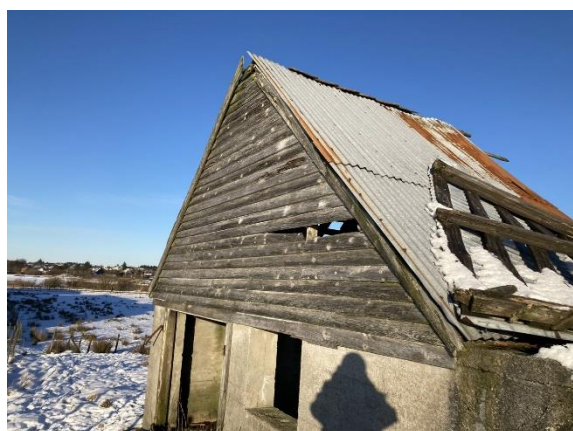
Figur 14: Låven har treverk med grønnskjær som sannsynligvis er CCA-impregnert.
