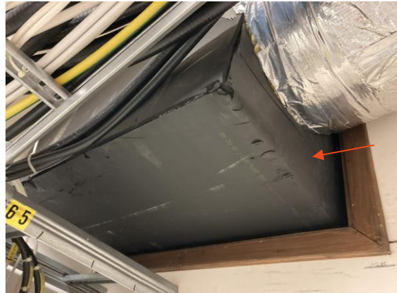
Figur 12: Cellegummi ble observert på kjøleanlegget.
