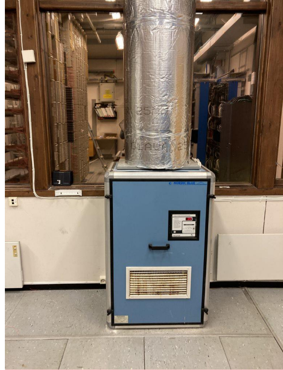
Figur 27: Kjøleanlegg observert i rom 112.
