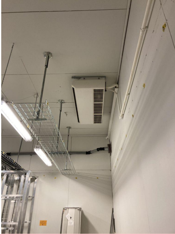
Figur 26: Kjøleanlegg observert i rom 111.
