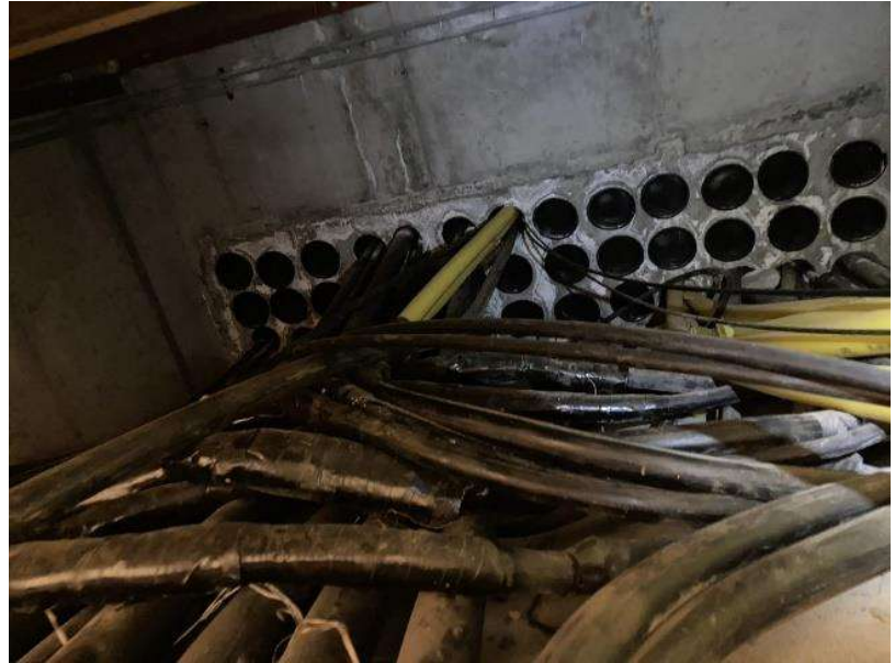
Figur 19: Kabelgjennomføringer i ringmuren. Bildet er tatt i kabelgangen under rom 113.
