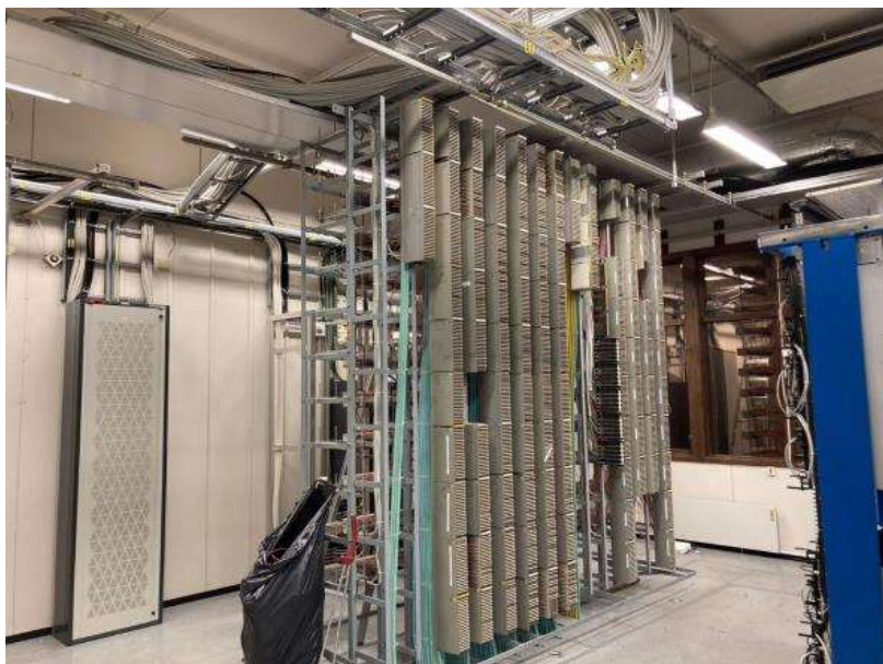
Figur 16: Det ble observert mye EE-avfall i Telenorbygget. Mye utstyr, som det vist på bildet, vil trolig fjernes av Telenor under utflytting.
