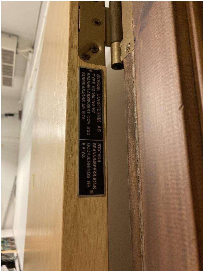
Figur 6: Eksempel på en brannør som ble observert i Telenorbygget. Denne brannøren er fra 1978, og kan dermed inneholde asbest.
