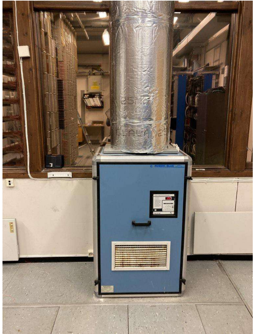
Figur 27: Kjøleanlegg observert i rom 112.
