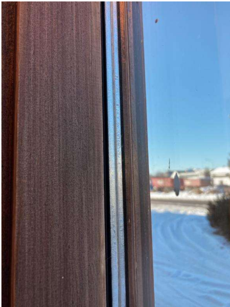
Figur 25: Vindu observert i Telenorbygget, av merket Flachglas. Det ble ikke observert årstall på avstandslisten, men utseendet tilsier at vinduet er eldre, trolig fra oppføringen av bygget. Disse skal håndteres som PCB-holdige.
