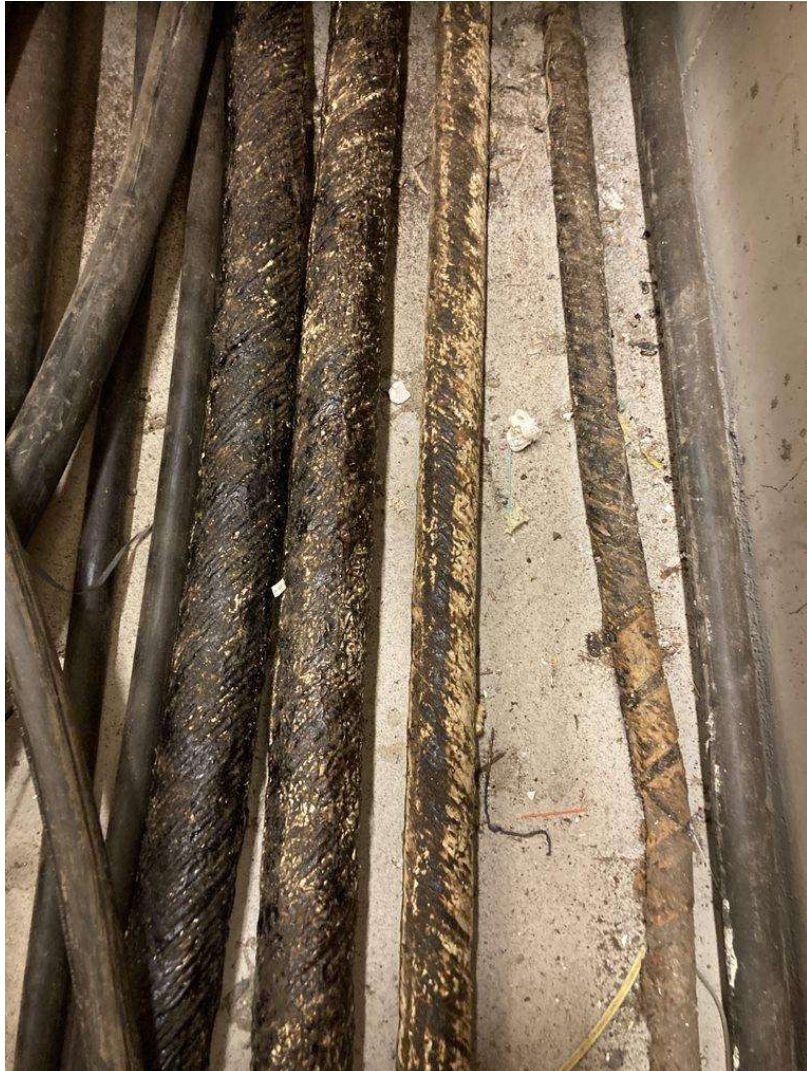
Figur 18: Det ble observert eldre trykksatte kabler i kabelganger under gulvet (rom 113). Disse kan inneholde PCB-holdig olje. Under demontering må kablene håndteres på en slik måte at eventuell olje ikke søler.
