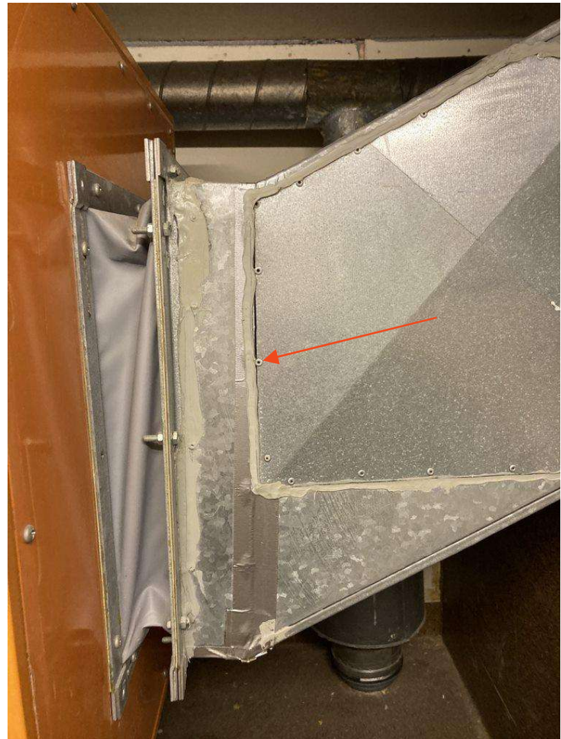
Figur 7: Grå, hard fugemasse på ventilasjonsanlegget ble prøvetatt for asbest, prøve T11 . Det ble ikke påvist asbest i prøven.
