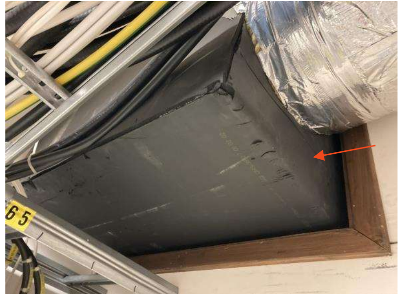
Figur 12: Cellegummi ble observert på kjøleanlegget.
