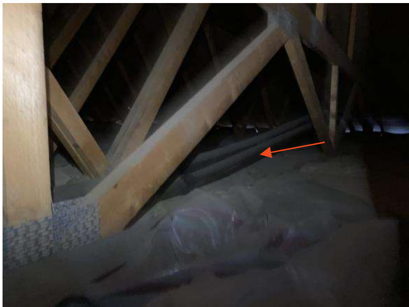
Figur 13: På kaldloftet ble det observert to rør isolert med cellegummi.
