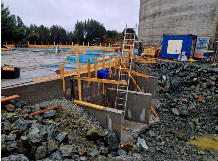
Foto: Anders Kristiansen Bilde fra underprosjekt Nytt høydebasseng på Håvik
