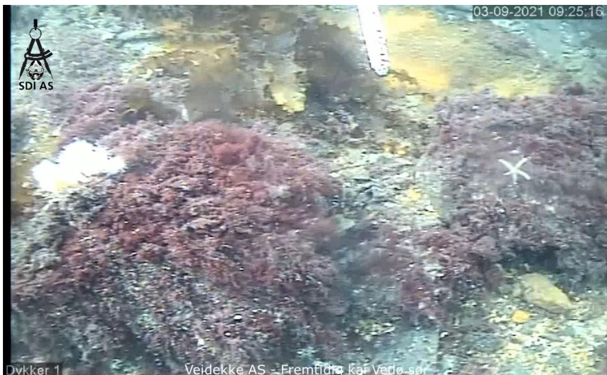
Dykker 1 Veidekke AS - Fremtidig kai Vedø sør. Bilde 2: Punkt A0. Ledd henger vedsiden av søyle på eksisterende kai.
