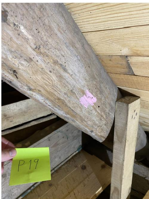
P19 – Prove tatt i nedre ende av taksperr
