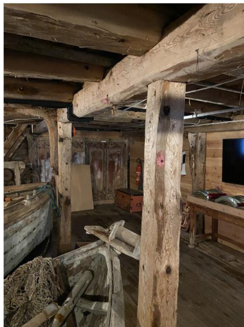
P1 - Stav i vestre midtvegg, litt nedenfor toppen av staven
