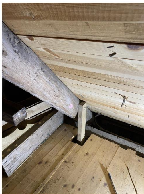
P19. Taksperr i vestre takflate
