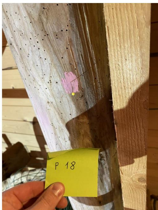
P18 – Prove tatt i taksperr
