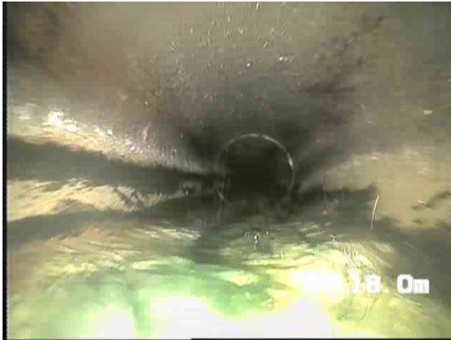
17.06.2022 12_51_21_420fc589-5b2c-45a4-be08-967c9d158f0c_20220617_125953_260.jpg, 00:03:20, 18.00 Deformasjonen er mellom 5 - 15 % av rørdimensjonen, på 6 Kl., Vertikalt - rørhøyden har blitt redusert
