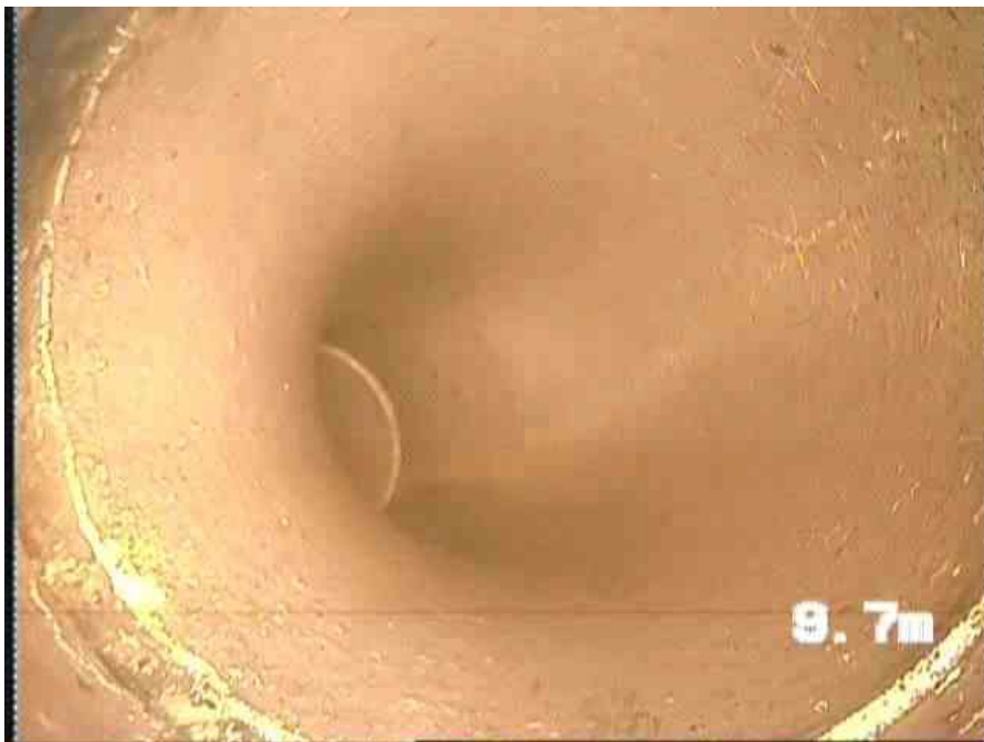
17.06.2022 12_40_16_cc35f8eb-13e2-4722-8b17-60d2cd5cba83_20220617_124736_148.jpg, 00:02:05, 9.70 Forsk. skjøt forskyvningen er mindre enn halve rørtykkelsen, av 6 Kl. til 11 Kl., Tverrforskjøvet
