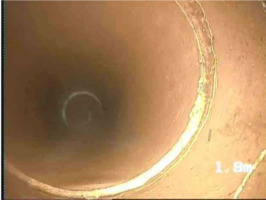
17.06.2022 12_40_16_b15b51dc-fc0a-4b7a-ad5b-354170235a20_20220617_124449_793.jpg, 00:00:52, 1.90 Sprukket rør, overflatesprekker,avskalling eller teglstein er delvis løse, av 12 Kl. til 12 Kl., Kompleks
