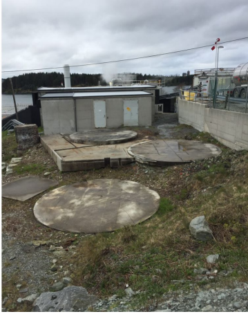
Bilde 5: fundamenter etter tre stk. tidligere tanker, som kan ses i bilde 3.
