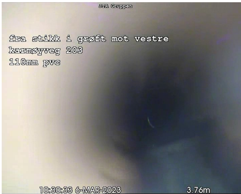
DF 3,80m Deformasjon, Gradering 1, Type: Punkt, Kl 6
