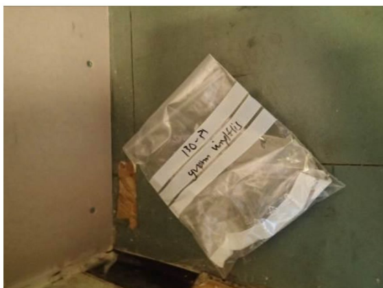
Bilde 12 viser prøve av grønne vinylfliser på rom 130. Flisene er asbestholdige.
