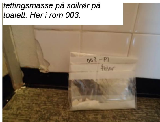
Bilde 22 viser hvit keramisk flis på rom 003 (toalett). Det ble ikke påvist asbest i prøven.
