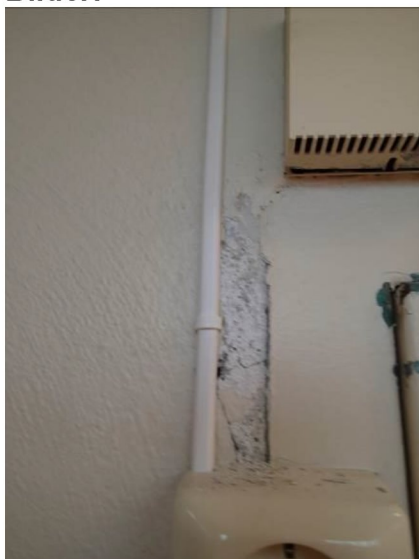
Bilde 63 viser eggehvitt maling på murvegg i rom 001. Malingen er forurenset, men ikke farlig avfall.
