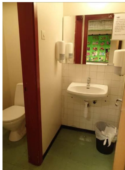
Bilde 8 viser grønne vinylfliser på gulv i rom 120. Flisene er ikke prøvetatt, men antas asbestholdige.
