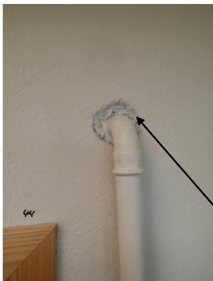
Bilde 19 viser tettingmasse rundt rør i rom 001. Det ble ikke påvist asbest i prøven.
