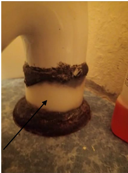
Bilde 43 viser eksempel på soilrør på toalett som kan inneholde asbest i skjøtene. Her i rom 019.
