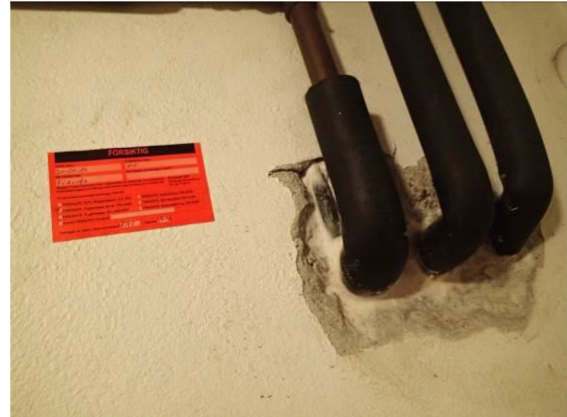
Bilde 49 viser cellegummi rundt rør på rom 048. Nyere fugemasse rundt rør.
