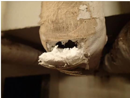
Bilde 48 viser isopor som isolasjon på rør i rom 023.
