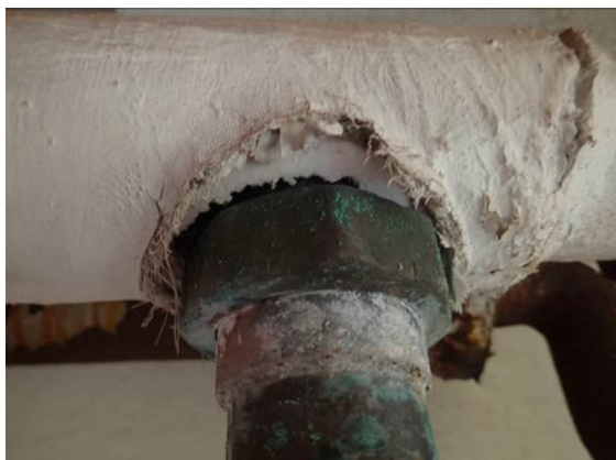
Bilde 38 viser eksempel på tettemasse rundt rør i bassengrom, rom 023, som bør prøvetas før evt. riving – hvis ikke bør den håndteres som asbestholdig.
