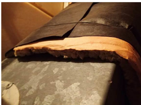
Bilde 39 viser rosa papp rundt ventilasjonskanal i vifferom over scenen i G-fløyen. Håndteres som asbestholdig
