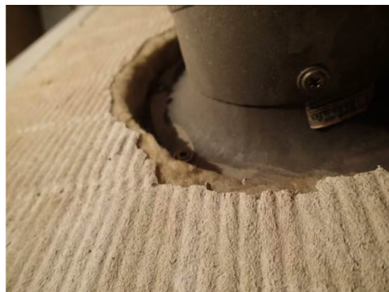
Bilde 40 viser papp rundt ventilasjonskanal i vifferom over scenen i G-fløyen. Håndteres som asbestholdig
