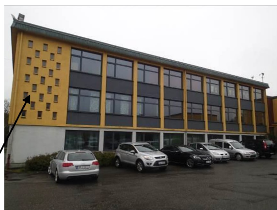
Bilde 37 viser fasadevinduer på REAL-bygget. Kittet rundt de små vinduene antas asbestholdig.
