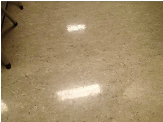
Bilde 54 viser grått vinylbelegg i rom 044, som ble prøvetatt. Belegget er farlig avfall med ftalater.
