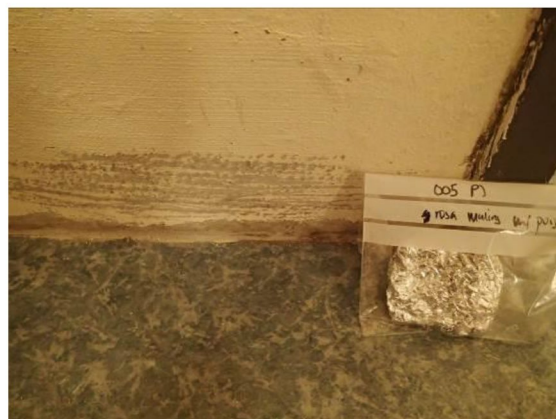
Bilde 64 viser rosa maling på murvegg i rom 005. Malingen er forurenset, men ikke farlig avfall.
