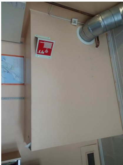
Bilde 28 viser plater i ventilasjonskanal i rom 044. Det ble ikke påvist asbest i prøven.
