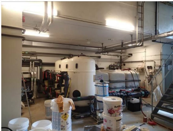
Bilde 56 viser malingspann i G-fløy rom 023
