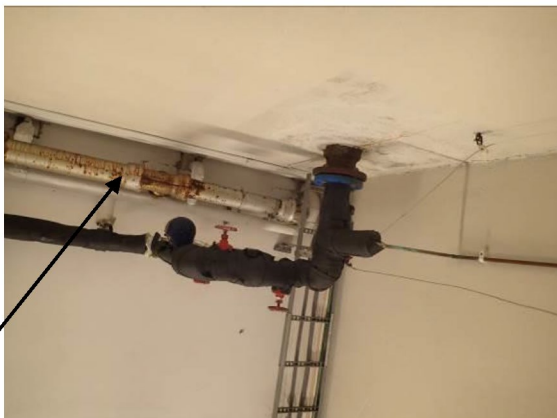
Bilde 44 viser eksempel på soilrør i rom 023
