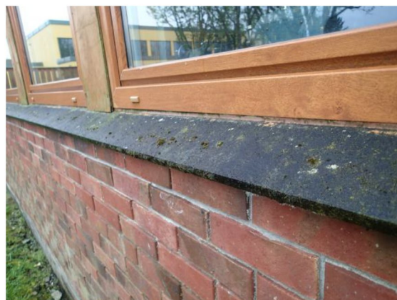
Bilde 41 viser eksempel på vindusbrett på fasade. Bør analyseres for asbest ved evt. rehabilitering.
