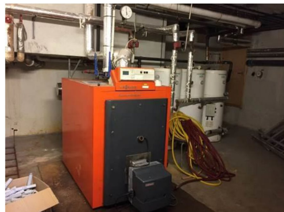
Bilde 61 viser ny Viessmann fyrkjele
