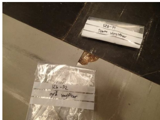
Bilde 35 viser prøver av grå og svarte vinylfliser i rom 126. Det er påvist asbest i de grå vinylflisene, men ikke i de svarte vinylflisene.
