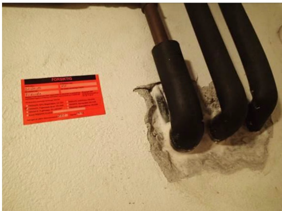
Bilde 58 viser eksempel på nyere fugemasse utført av Firesafe i 2014. Leveres som farlig avfall med klorparafiner.
