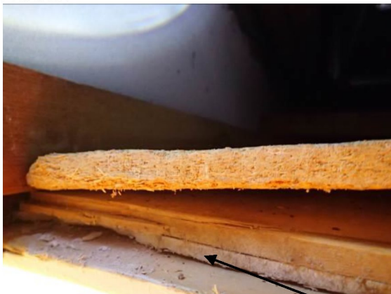
Bilde 1 viser himlingsplater i rom 005. Prøve 005-P4 påviste amosittasbest.
