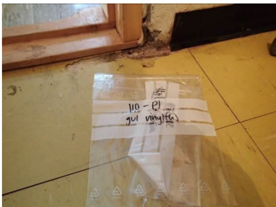
Bilde 5 viser gul vinylflis prøvetatt på rom 110. Det ble påvist asbest i vinylflisen.
