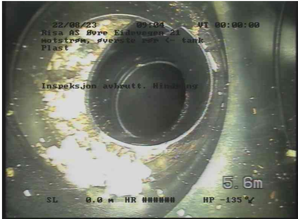
23.08.2022 09_00_46_64d88c64-b8cd-4f07-9d3c-ef4035797ecf_20220823_090617_914.jpg, 00:00:51, 5.60 Inspeksjon avbrutt. Hindring / mindre dimensjon. Takvann er tilkoblet
