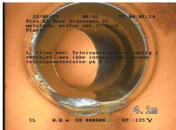
23.08.2022 08_39_49_e168f57b-c4bd-488c-bd21-4286ea9315ea_202208 23_084321_596.jpg, 00:01:12, 4.10 1, Stive rør: Tetningsringen er synlig i rørskjøt, men ikke innhengende, andre tetningsmaterialer på 6 Kl.
