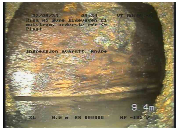
23.08.2022 08_32_08_56d872d9-ea44-4729-8f86-dc64ed7a1a7e_20220823_083648_443.jpg, 00:01:48, 9.40 Inspeksjon avbrutt. Andre / ser ut som en kum
