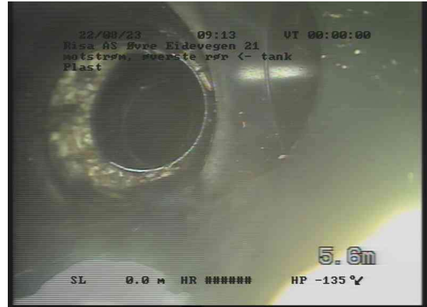
23.08.2022 09_00_46_7a2c54e4-c063-4a5f-a350-e6cf93d0e391_20220823_091552_640.jpg, 00:00:51, 5.60 Inspeksjon avbrutt. Hindring / mindre dimensjon. Takvann er tilkoblet
