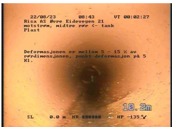
23.08.2022 08_39_49_854612e3-4261-43f2-8913-4f2ca70ed7ac_202208 23_084537_423.jpg, 00:02:25, 10.20 Deformasjonen er mellom 5 - 15 % av rør dimensjonen, punkt deformasjon på 5 Kl.
