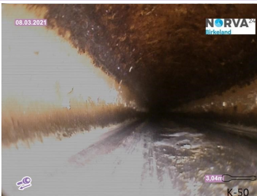
Spillvann_Inn til hus_Septik tank_20210308_105900.jpg
