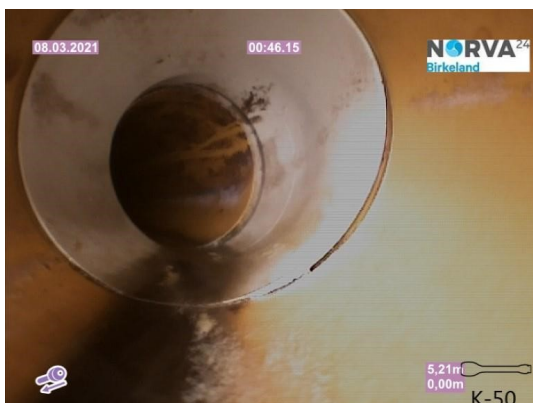
Spillvann_Inn til hus_Septik tank_20210308_110013.jpg
