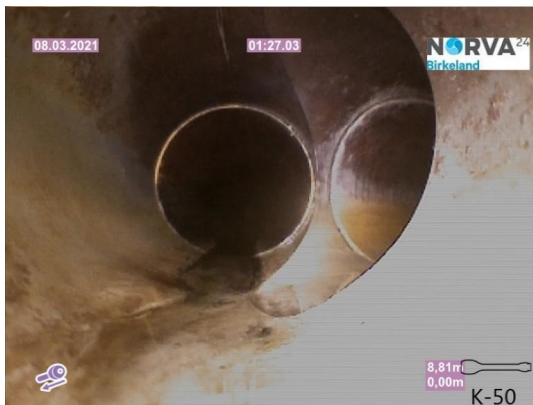
Spillvann_Inn til hus_Septik tank_20210308_110059.jpg
