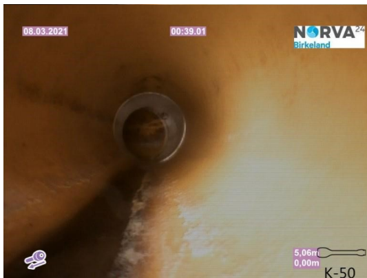
Spillvann_Inn til hus_Septik tank_20210308_105957.jpg
