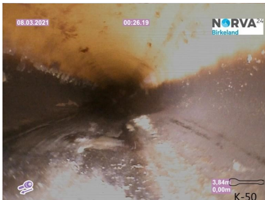
Spillvann_Inn til hus_Septik tank_20210308_105936.jpg
