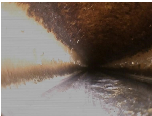
Spillvann_Inn til hus_Septik tank_20210308_105902.jpg
