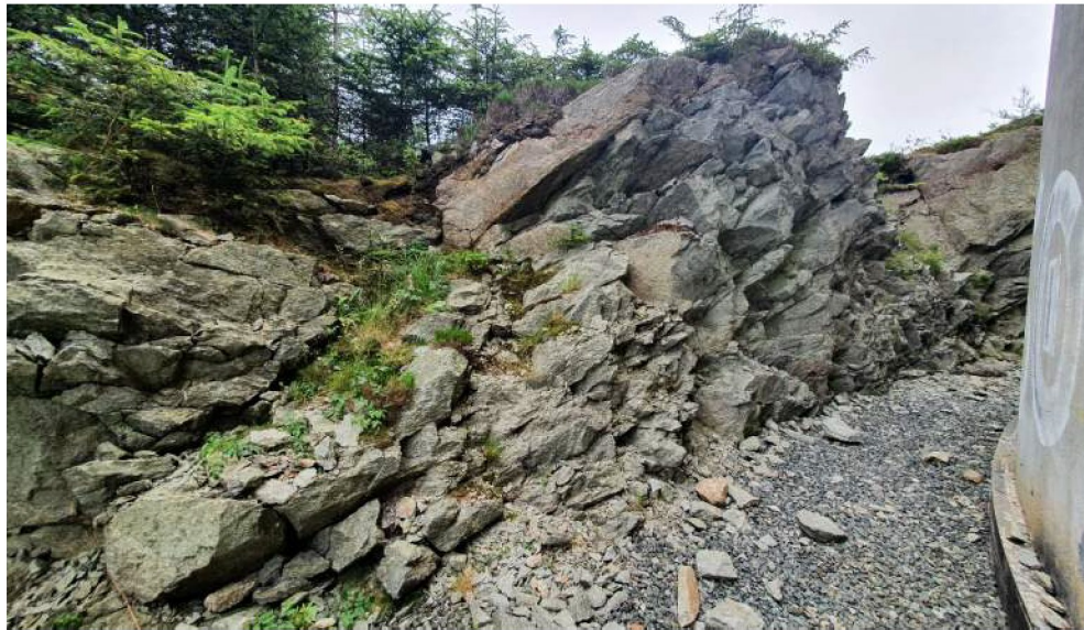
Figur 11: Skjæring rundt eksisterende høydebasseng ved Arareir. Det observeres en del nedfall ved skjæringsfoten og flere blokker i skjæringen er løse. Bildet er tatt mot sørøst. Eksisterende høydebasseng sees til høyre i bildet.
