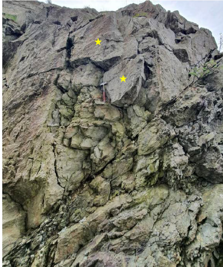
Figur 12: Del av skjæring rundt eksisterende høydebasseng der det er observert blokker (merket med stjerner) som kan være aktuelle å bolte fast pga. størrelse til både låseblokk og overliggende blokk. Det er kun gjort en kjapp vurdering av merkede blokker og det kan ikke utelukkes at det kan være andre blokker i bildet og ellers i skjæringen som også burde vært sikret. For øvrig sees tett oppsprekking langs foliasjonssprekk som går diagonalt i bildet. Bildet er tatt mot sørøst med hammer for skala.
