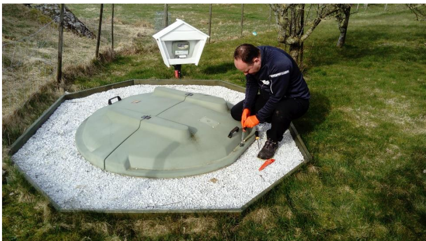
Wilhelm Fjetland Trodahl, tilsyns- og kvalitetskontrollør avløp i Karmøy kommune og leder av tilsynsgruppe spredt avløp, kjenner alle triksene i boka. Her «dirker» han opp en lås.
