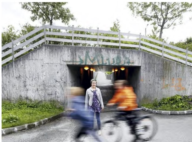
Figur 2.27: Undergang i Karmsundgata som tidligere har blitt utbedret for å bedre siktforholdene for myke trafikanter. Foto: Haugesunds Avis.
