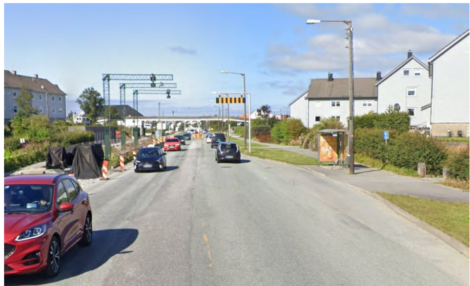
Figur 2.14: Bomstasjon i Karmsundgata, sett fra sør (tidligere byggefase). Google Street view.
