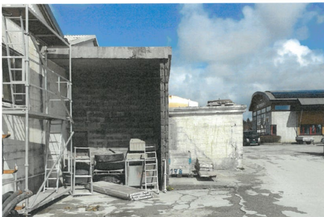
Fra sørside. Byggets gamle påbygg/tilbygg ønskes revet slik at bygget fremstår som en helhetlig bygningsmasse.
