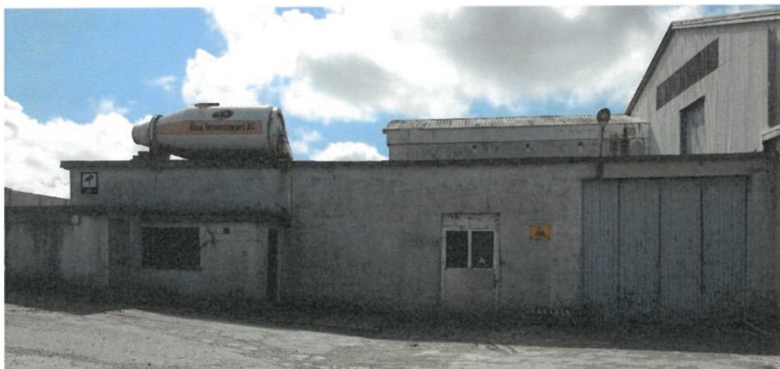
Fra nordside. Gammel del som ønskes revet og erstattes med ny rett vegg. Lagerport i nord er eneste mulig inngang til dette lageret som kun benyttes til intern kjøring.
