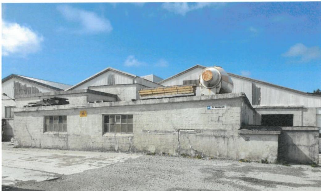
Fra østside. Her vises sprukne gamle vegger som trekker fuktighet. De er også betydelig skjeve i forhold til resten av bygget. Terrengnet er ca. 1,2 til 1,5 meter høyere på utsiden enn innvendig gulvhøyde.
