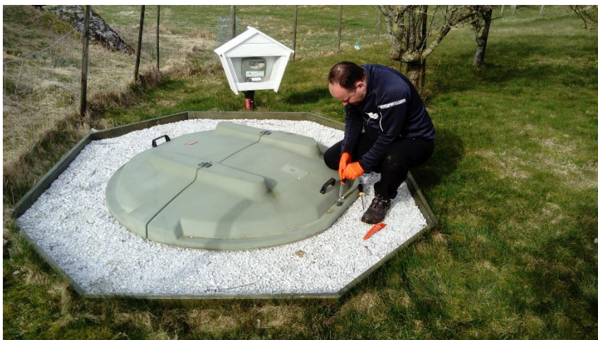
Wilhelm Fjetland Trodahl, tilsyns- og kvalitetskontrollør avløp i Karmøy kommune og leder av tilsynsgruppe spredt avløp, kjenner alle triksene i boka. Her «dirker» han opp en lås.
