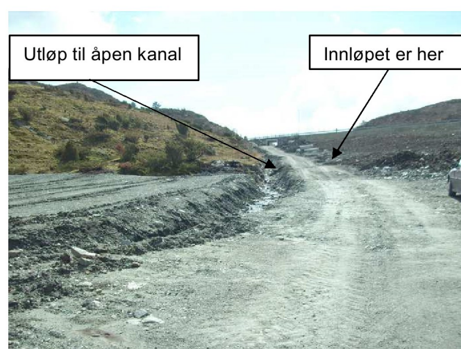
12. Etablert (ikke planlagt) rør under Kjerkevegen for overflatevann fra sørøstlig del av felt 1.
