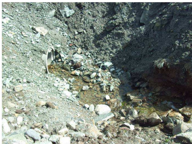
7. Innløp fra kanal på bnr. 2, rørgjennomføring under Kjerkevegen (se pkt. 7 i vilkår).
