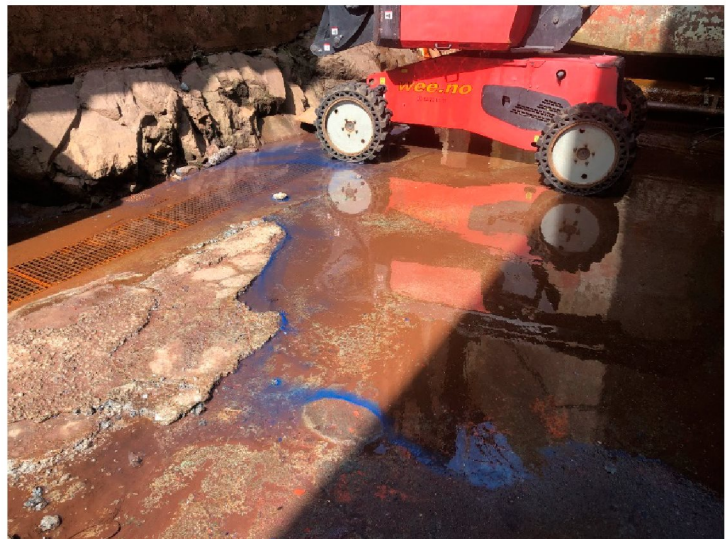
Bilde 1: Malingsrester på dokkgulvet
