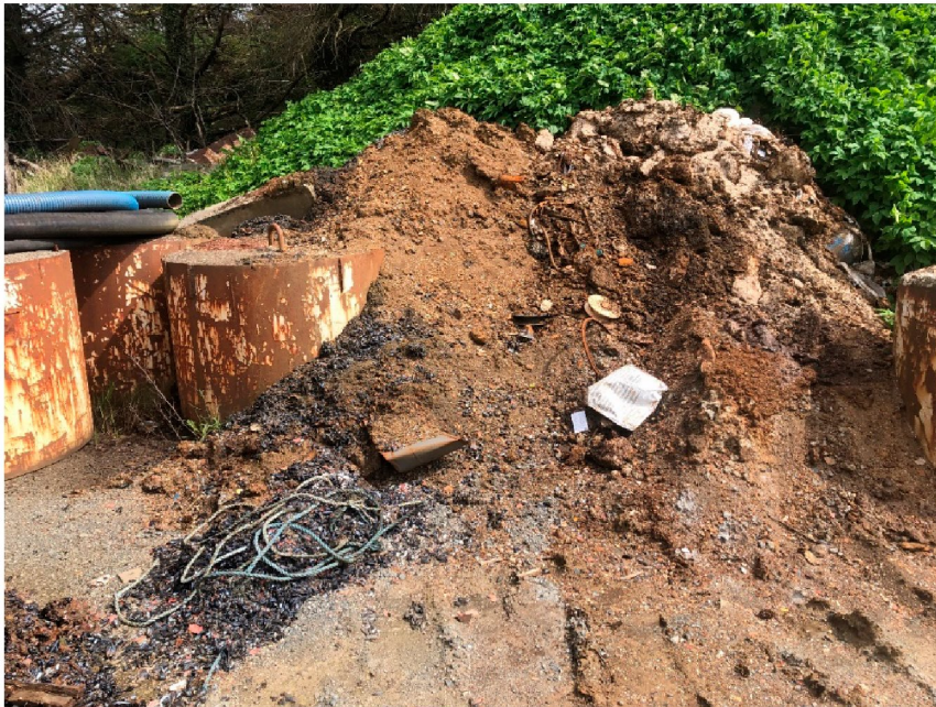
Bilde 2: Avvirket materiale bak hall/rubbhall
