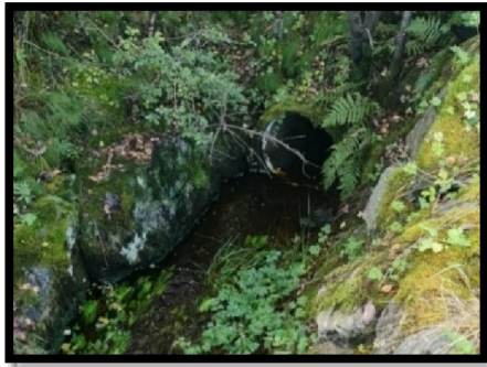
Figur 28 – Rør mot sør, tilgrensende planområdet, åpen grøft parallelt med Sundvegen ender i rør.
