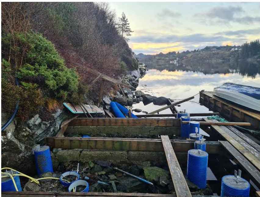
Bildet viser nødvendig rehabilitering av eks. brygge fra 1970.
