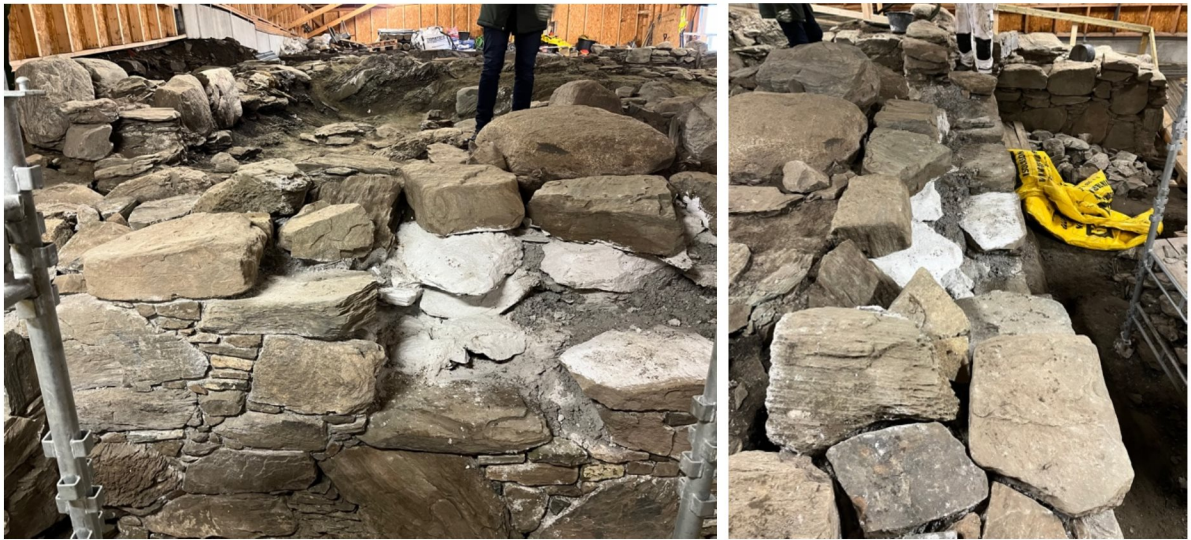
Bildet til venstre viser mur A7 mot nord og manglende fasade i murverket. Her ønsker vi å få tilført to skift med murverk. Bildet til høyre viser samme mur sett fra vest mot øst.
