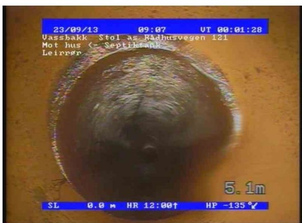
13.09.2023 08_56_59_d60d4123-b5a3-4fd2-936a-e3d2fa6353dc_202309 14_080819_831.jpg, 00:01:29, 5.10 Forsk. skjøt forsk. er mellom hele og 2 ganger rørtyk. eller skjøten er delvis åpen, av 9 Kl. til 3 Kl., Tverrforskjøvet
