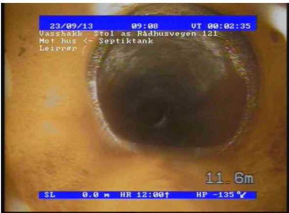
13.09.2023 08_56_59_d41fd711-63a0-44e9-a4b7-e6f9911c4380_20230914_081122_188.jpg, 00:02:35, 11.60 Forsk. skjøt forsk. er mellom hele og 2 ganger rørtyk. eller skjøten er delvis åpen, av 8 Kl. til 4 Kl., Tverrforskjøvet
