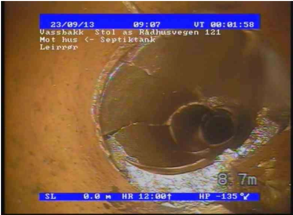
13.09.2023 08_56_59_422bead3-1e57-4060-b31d-9c4178dd407c_20230914_080950_782.jpg, 00:01:58, 8.70 Sprukket rør, kollaps, av 12 Kl. til 12 Kl., Kompleks
