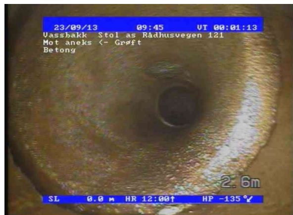
13.09.2023 09_25_09_747145b0-e8e5-4ef2-8db1-31a3d8ecbbe1_20230914_081659_223.jpg, 00:01:14, 2.60 Forsk. skjøt forsk. er mellom hele og 2 ganger rørtyk. eller skjøten er delvis åpen, av 3 Kl. til 9 Kl., Tverrforskjøvet
