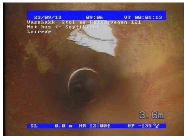
13.09.2023 08_56_59_d9926195-8082-4238-affe-ca940330c240_202309 14_080739_392.jpg, 00:01:14, 3.60 Sprukket rør, Rørbiten har løsnet eller teglstein mang. fra sin oppr. posisjon, av 12 Kl. til 1 Kl., Tangentiell
