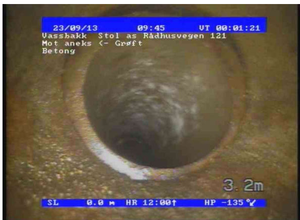
13.09.2023 09_25_09_ae515d62-2985-490b-af7b-50a9a1cab82c_20230914_081734_902.jpg, 00:01:21, 3.20 Forsk. skjøt forsk. er mellom hele og 2 ganger rørtyk. eller skjøten er delvis åpen, av 12 Kl. til 12 Kl., Lengdeforskjøvet
