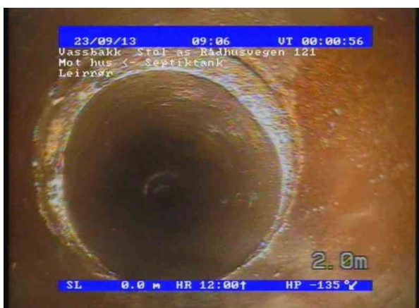
13.09.2023 08_56_59_cfd29967-6bce-47c0-93a1-c377e2202db2_20230914_080553_486.jpg, 00:00:57, 2.00 Forsk. skjøt forsk. er mellom hele og 2 ganger rørtyk. eller skjøten er delvis åpen, av 8 Kl. til 4 Kl., Tverrforskjøvet
