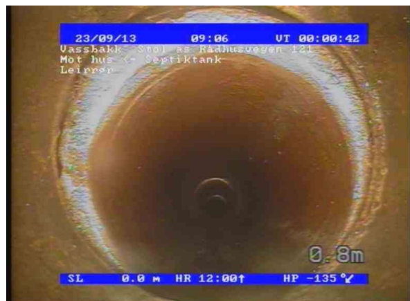
13.09.2023 08_56_59_60d155f6-4527-42f0-8906-46af121a7061_20230914_080515_794.jpg, 00:00:42, 0.80 Forsk. skjøt forsk. er mellom hele og 2 ganger rørtyk. eller skjøten er delvis åpen, av 9 Kl. til 3 Kl., Tverrforskjøvet
