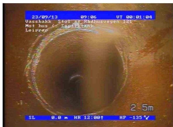
13.09.2023 08_56_59_bb0375d2-21c0-4655-b62e-99aa4779e3f9_20230914_080630_348.jpg, 00:01:05, 2.50 Forsk. skjøt forsk. er mellom hele og 2 ganger rørtyk. eller skjøten er delvis åpen, av 9 Kl. til 3 Kl., Tverrforskjøvet
