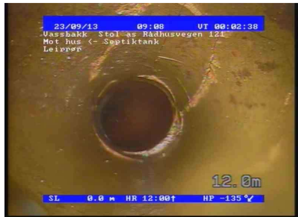
13.09.2023 08_56_59_410f0649-6540-471b-9def-bdba16af29e5_20230914_081152_762.jpg, 00:02:38, 12.00 Sprukket rør, sprekkene er åpne/løse teglstein, av 10 Kl. til 2 Kl., Tangentiell
