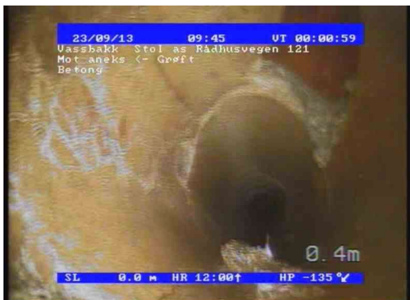
13.09.2023 09_25_09_21f7a401-8363-4b7f-8665-521a5a6f16ba_20230914_081608_216.jpg, 00:01:00, 0.40 Sprukket rør, Rørbiter har løsnet eller teglstein mang. fra sin oppr. posisjon, av 11 Kl. til 1 Kl., Tangentiell
