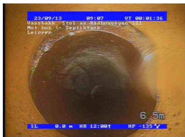
13.09.2023 08_56_59_268229ef-1d8a-4c8f-8bbe-a9c282e58f67_2023091 4_080854_852.jpg, 00:01:36, 6.50 Forsk. skjøt forsk. er mellom hele og 2 ganger rørtyk. eller skjøten er delvis åpen, av 9 Kl. til 3 Kl., Tverrforskjøvet
