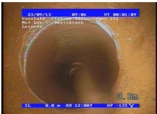
13.09.2023 08_56_59_dc8d4319-4f33-4b3b-a51c-b73d6c89e58d_202309 14_080703_290.jpg, 00:01:10, 3.30 Forsk. skjøt forskyvningen er mellom halve og hele rørtykkelsen, av 9 Kl. til 3 Kl., Tverrforskjøvet
