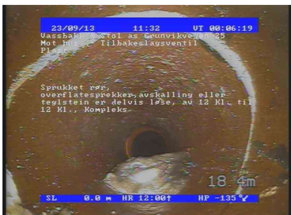
13.09.2023 10_47_59_a017f9bf-2dcb-45a7-97bd-eec68cb3f38b_2023091 3_112528_974.jpg, 00:06:16, 18.40 Sprukket rør, overflatesprekker, avskalling eller teglstein er delvis løse, av 12 Kl. til 12 Kl., Kompleks
