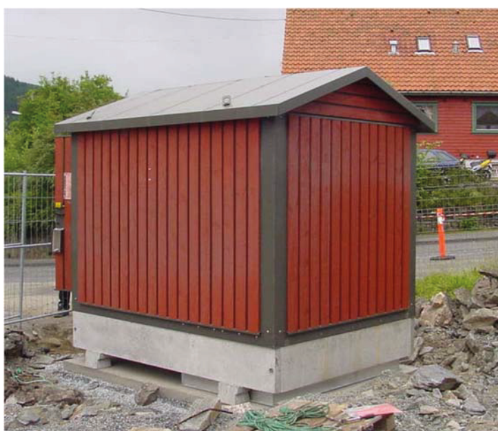
Figur 6. Prefabrikkert kiosk (bilde tatt av BKK AS)
