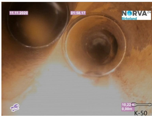
Spillvann_Inn til hus_Kum i innkjørsel_20201111_143921.jpg
