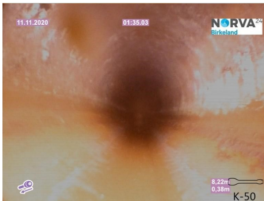
Spillvann_Inn til hus_Kum i innkjørsel_20201111_143834.jpg
