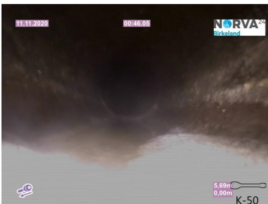
Spillvann_Inn til hus_Kum i innkjørsel_20201111_143731.jpg
