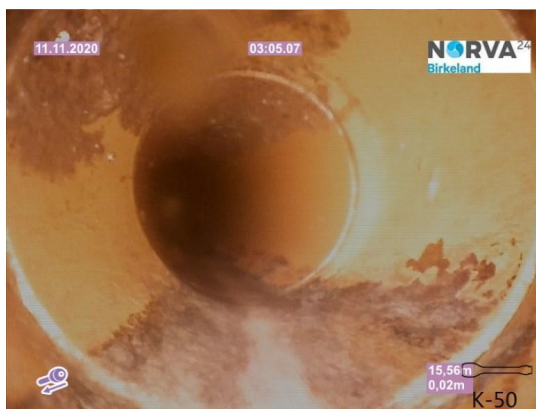
Spillvann_Inn til hus_Kum i innkjørsel_20201111_144053.jpg
