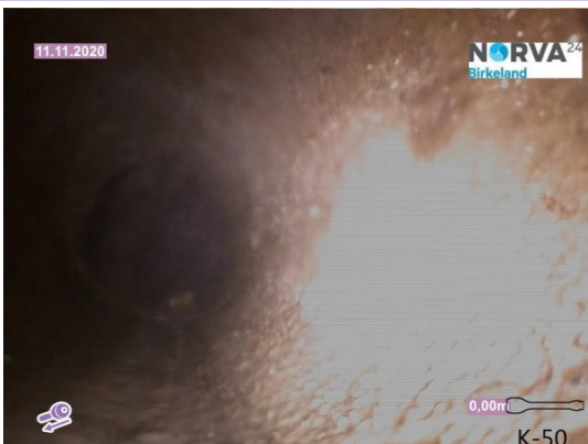
Spillvann_Inn til hus_Kum i innkjørsel_20201111_143454.jpg
