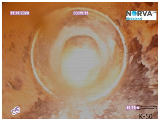
Spillvann_Inn til hus_Kum i innkjørsel_20201111_144143.jpg
