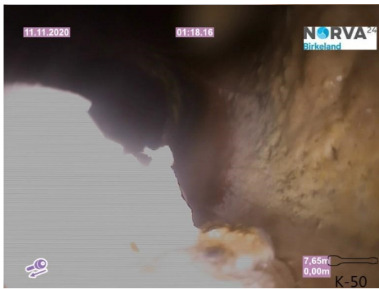
Spillvann_Inn til hus_Kum i innkjørsel_20201111_143811.jpg
