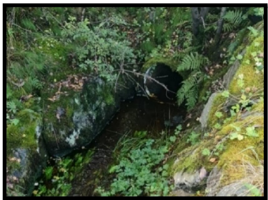
Figur 31 – Rør mot sør, tilgrensende planområdet, åpen grøft parallelt med Sundvegen ender i rør.
