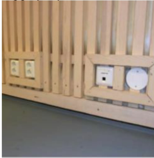
Foto: Morten Roa Eksempel på beskyttelse av elektriske installasjoner
