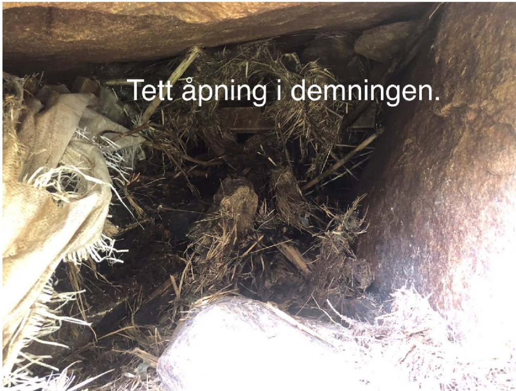
Åpningen i demningen var tettet helt igjen av en duk og annet «rask».
