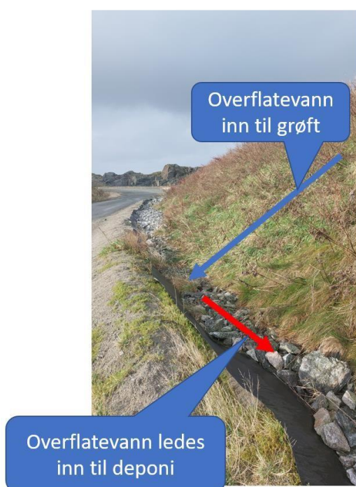
Figur 17 Overflateavrenningen føres ned til grøft og videre infiltreres dette og går inn under deponiet.
