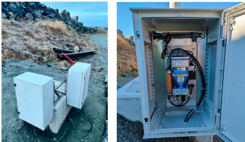
Figur 8 Skap med måleutstyr ved K3.
