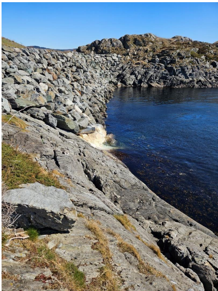
Figur 19 Utslipp over havnivå fra utslippsrør 3. Hvitt belegg er utfellinger.
