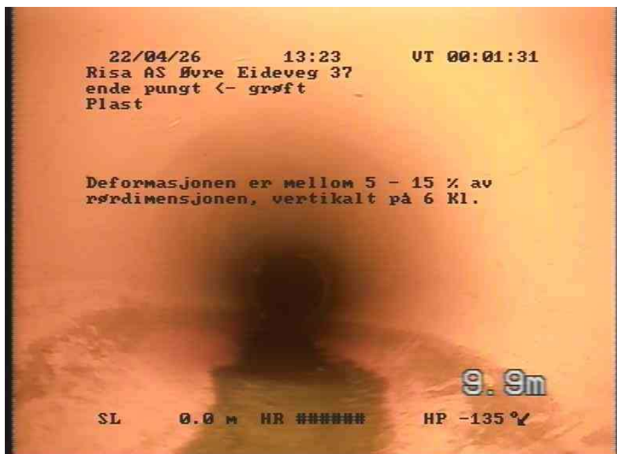
26.04.2022 13_18_45_ea5d010f-60c2-4da8-a459-3166d4100b8c_20220426_132322_221.jpg, 00:01:29, 9.90 Deformasjonen er mellom 5 - 15 % av rørdimensjonen, vertikalt på 6 Kl.
