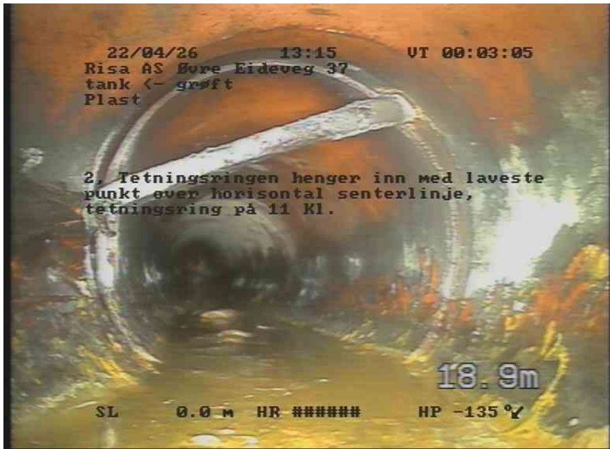
26.04.2022 13_08_11_1e30ce4f-3f3e-4e73-8a6d-2a8acc950c9_20220426_131522_023.jpg, 00:03:03, 18.90 2, Tetningsringen henger inn med laveste punkt over horisontal senterlinje, tetningsring på 11 Kl.
