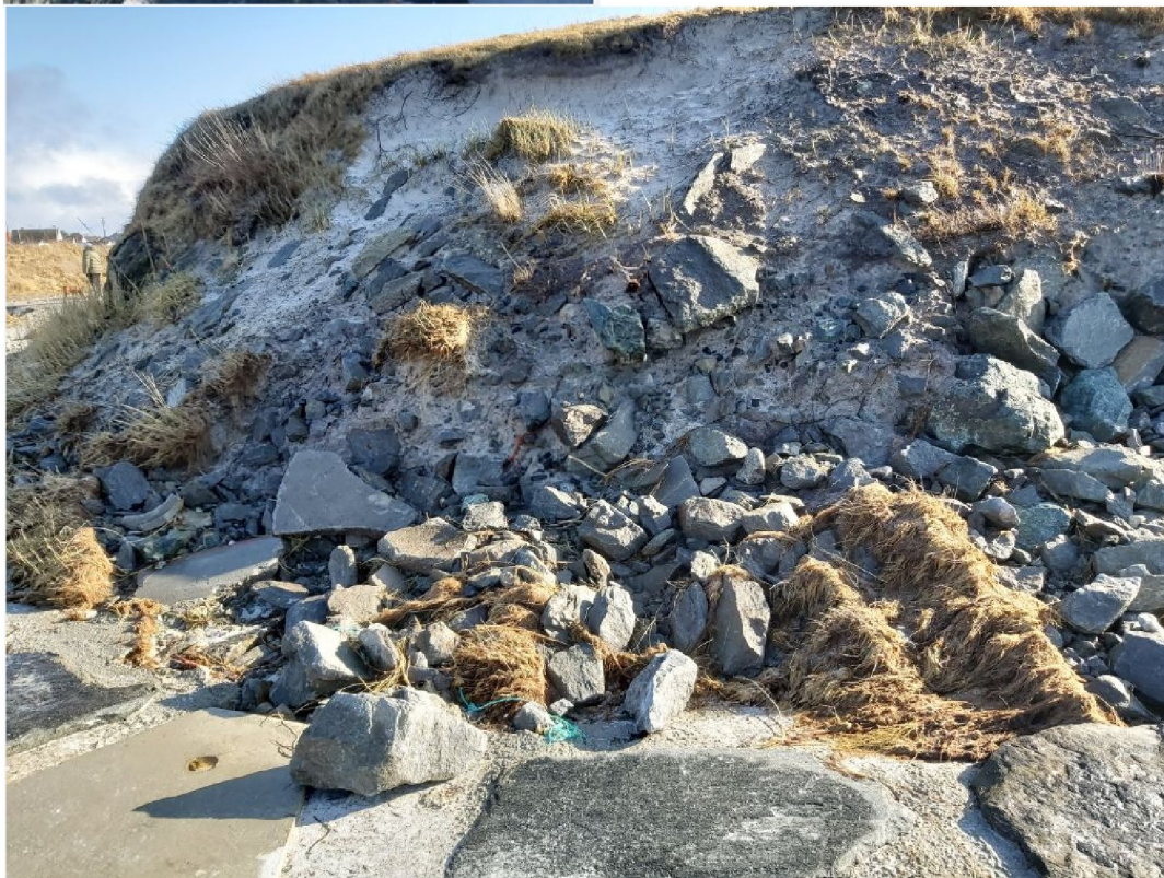
Bilde 7 og 8. Skader fra Storm februar 2020
