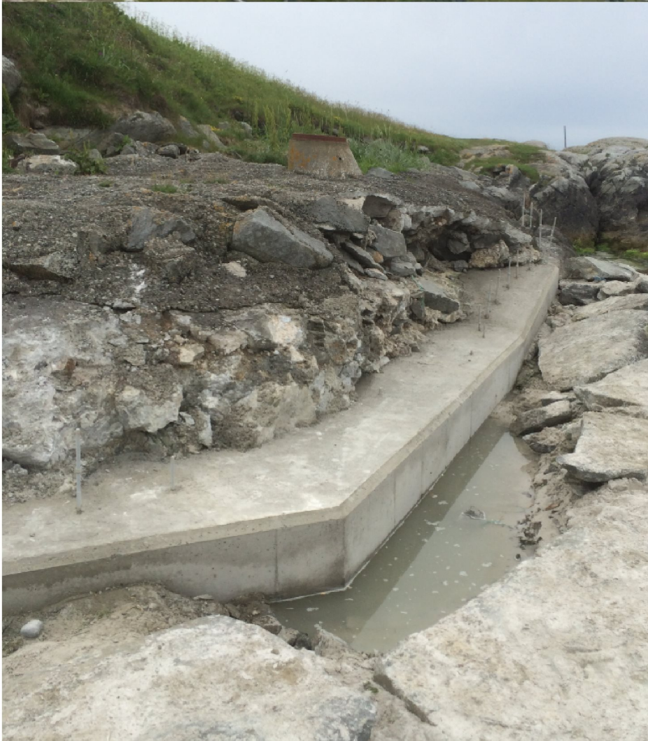
Bilde 4 og 5. Skader og reparasjon etter storm i 2016. Fundament er i dag inntakt og er fundament for ny mur som beskytter nytt rør som ble lagt i 2018
