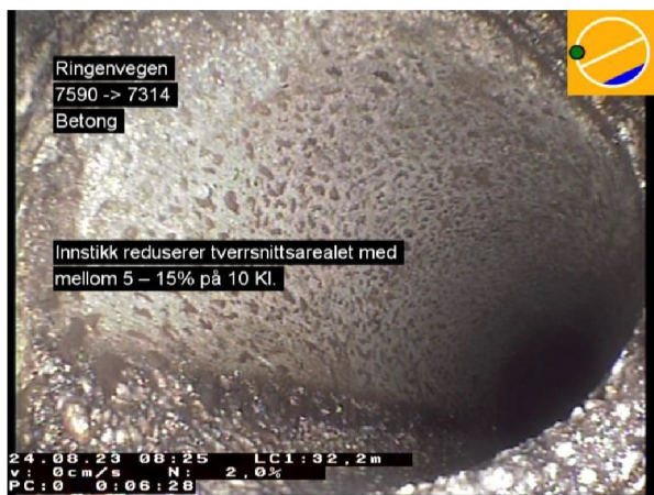
24.08.2023 080713_7314_7590_24082023_080913_008.jpg, 00:06:27, 32.20m Innstikk reduserer tverrsnittsarealet med mellom 5 – 15% på 10 Kl.
