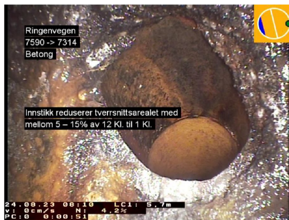
24.08.2023 080713_7314_7590_24082023_080913_003.jpg, 00:00:50, 5.70m Innstikk reduserer tverrsnittsarealet med mellom 5 - 15% av 12 Kl. til 1 Kl.
