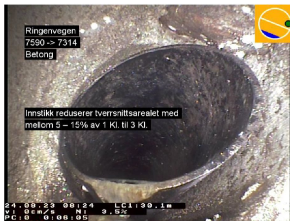
24.08.2023 080713_7314_7590_24082023_080913_007.jpg, 00:06:03, 30.10m Innstikk reduserer tverrsnittsarealet med mellom 5 – 15% av 1 Kl. til 3 Kl.
