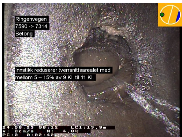
24.08.2023 080713_7314_7590_24082023_080913_006.jpg, 00:02:41, 13.90m Innstikk reduserer tverrsnittsarealet med mellom 5 – 15% av 9 Kl. til 11 Kl.
