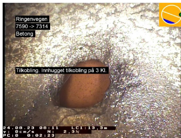
24.08.2023 080713_7314_7590_24082023_080913_005.jpg, 00:02:21, 13.30m Tilkobling. Innhugget tilkobling på 3 Kl.
