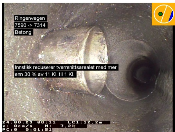
24.08.2023 080713_7314_7590_24082023_080913_004.jpg, 00:01:50, 12.20m Innstikk reduserer tverrsnittsarealet med mer enn 30 % av 11 Kl. til 1 Kl.
