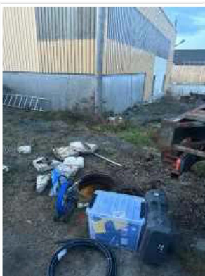
Pipemic lytting fra kum ved nabobygg i sør, fant ingen lekkasje her. Punkt 2.
