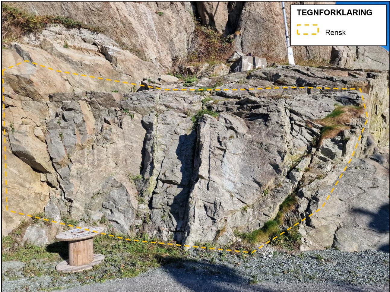
Foto 13: Anvist bergsikring i midtre del av skjæring.
