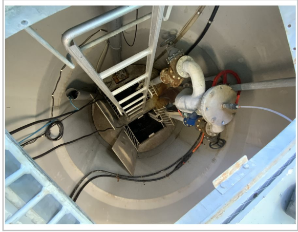
Sikkerhetsrister nede i sump åpne.
