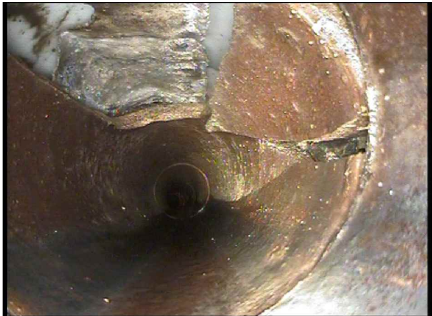
Foto: Stakeluke inne_Påkobling_104846.jpg 8,13m, Sprukket rør, Rørbiter har løsnet eller teglstein mang. fra sin oppr. posisjon, 10 - 3 Kl., Kompleks
