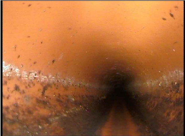
Foto: Stakeluke inne_Påkobling_105234.jpg 41,65m, Inspeksjon avbrutt Utstyrsfeil, Vannstand: 0 %
