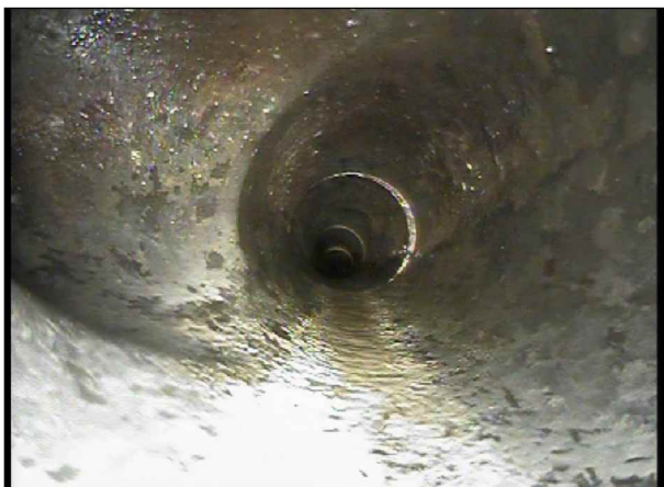
Foto: Toalett 1etg_kum veg_100153.jpg 2,3m, Tilkopling Prefabrikkert grenrør., 9 Kl.
