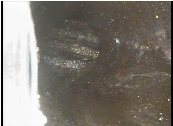
Foto: Toalett 1etg_kum veg_100300.jpg 7,09m, Plugget tilkopling 9 Kl.
