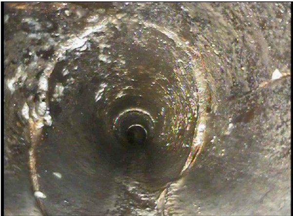
Foto: Toalett 1etg_kum veg_100530.jpg 18,61m, Sprukket rør, Rørbiter har løsnet eller teglstein mang. fra sin oppr. posisjon, 12 - 12 Kl., Kompleks
