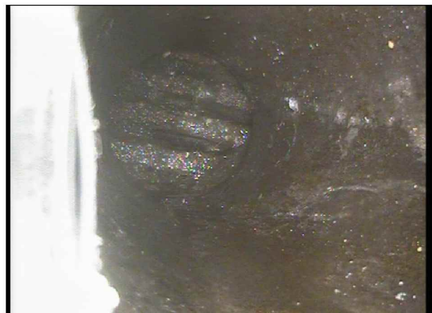
Foto: Toalett 1etg_kum veg_100249.jpg 7,09m, Tilkopling Prefabrikkert grenrør., 9 Kl.
