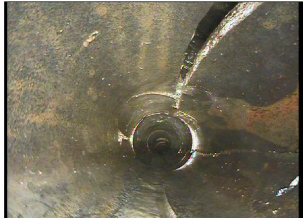
Foto: Toalett 1etg_kum veg_100356.jpg 13,23m, Sprukket rør, Rørbiter har løsnet eller teglstein mang. fra sin oppr. posisjon, 12 - 6 Kl., Kompleks
