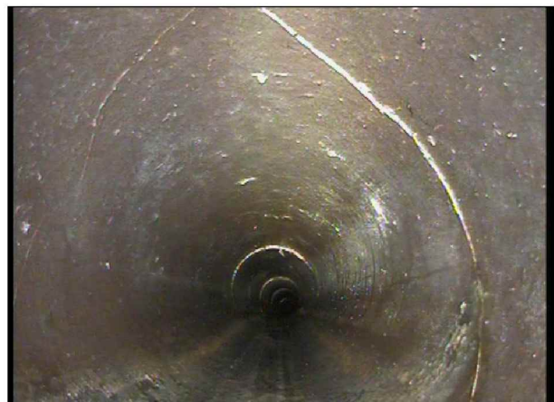
Foto: Toalett 1etg_kum veg_100457.jpg 16,34m, Sprukket rør, sprekke er åpne/løse teglstein, 12 - 12 Kl., Kompleks
