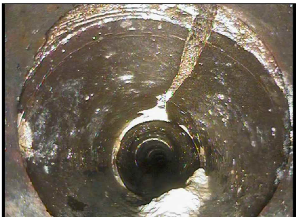
Foto: Toalett 1etg_kum veg_100432.jpg 14,95m, Sprukket rør, Rørbiter har løsnet eller teglstein mang. fra sin oppr. posisjon, 12 - 12 Kl., Kompleks
