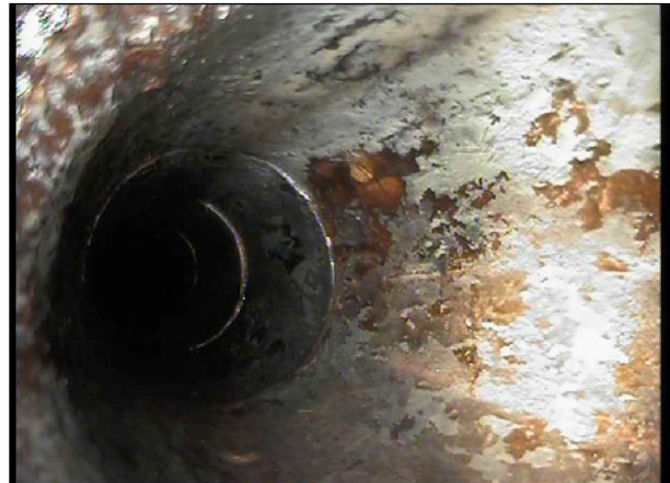
Foto: Toalett 1etg_kum veg_100104.jpg 0,57m, Tilkopling Prefabrikkert grenrør., 3 Kl.
